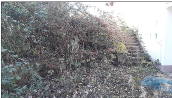
Abbildung 8: Mit Brombeere überwachsene Mauer und Treppenaufgang am Wohnhaus.
